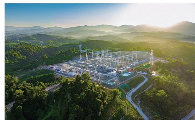
位于老挝乌多姆塞省的 500 千伏那磨变电站。中国南方电网公司供图
