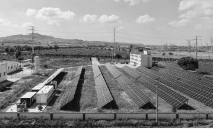
光伏直联制氢示范项目全景图。 受访者供图
