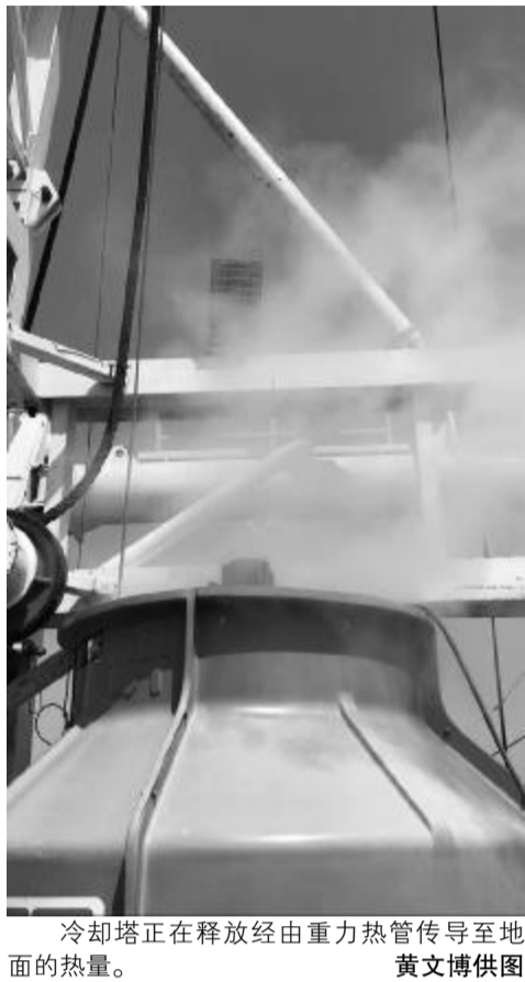
冷却塔正在释放经由重力热管传导至地面的热量。 黄文博供图
