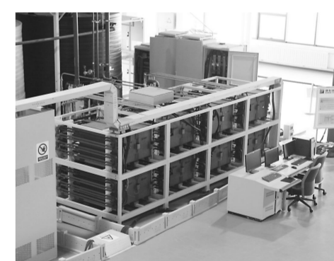
融科储能开发的176千瓦全钒液流电池模块
