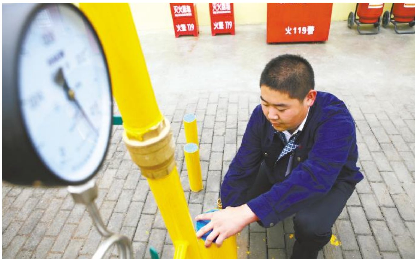
9月10日,甘肃兰州,轻烃供热供气站工作人员正在查看仪器设备。这标志着该市在快速而有效地治理煤污染方面有了重大突破,有望在全国综合防控PM2.5中后来居上。CFP供图
