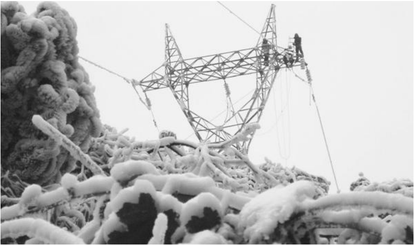
北京11月4日雪灾中,延庆15条高压供电线路出现故障,导致57个村供电中断。
