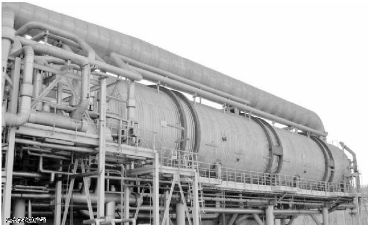
海水淡化蒸发器
