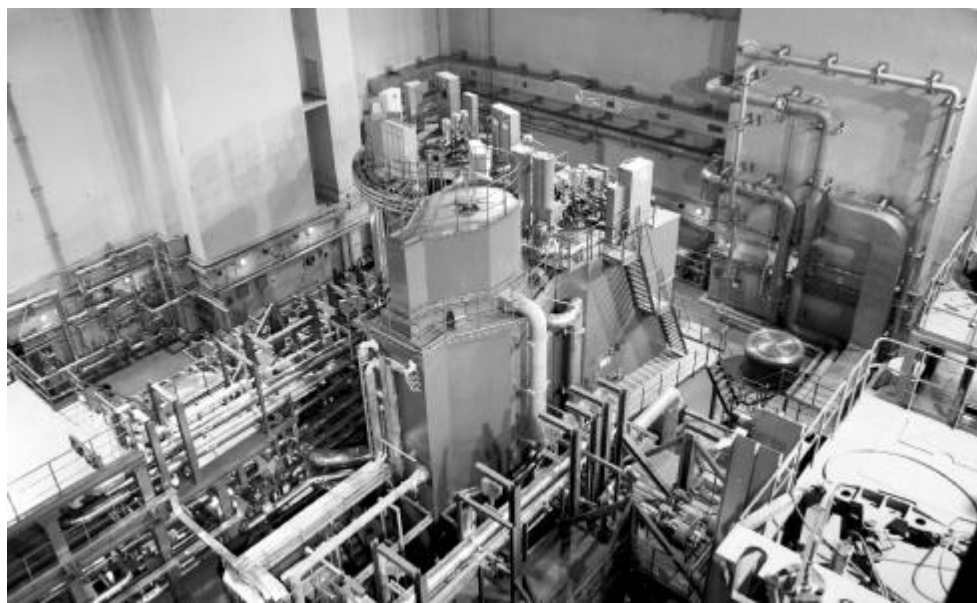
中国实验快堆反应堆大厅
