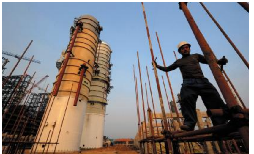
武汉80万吨乙烯项目建设已过半,设备安装正加紧进行,预计2013年一季度投料运行。该项目将直接带来200多亿元的销售,同时能带动下产业1200多亿元的产值,给10万人提供就业机会。图为11月1日工人在乙烯项目建设工地施工。 新华社记者 程敏摄
