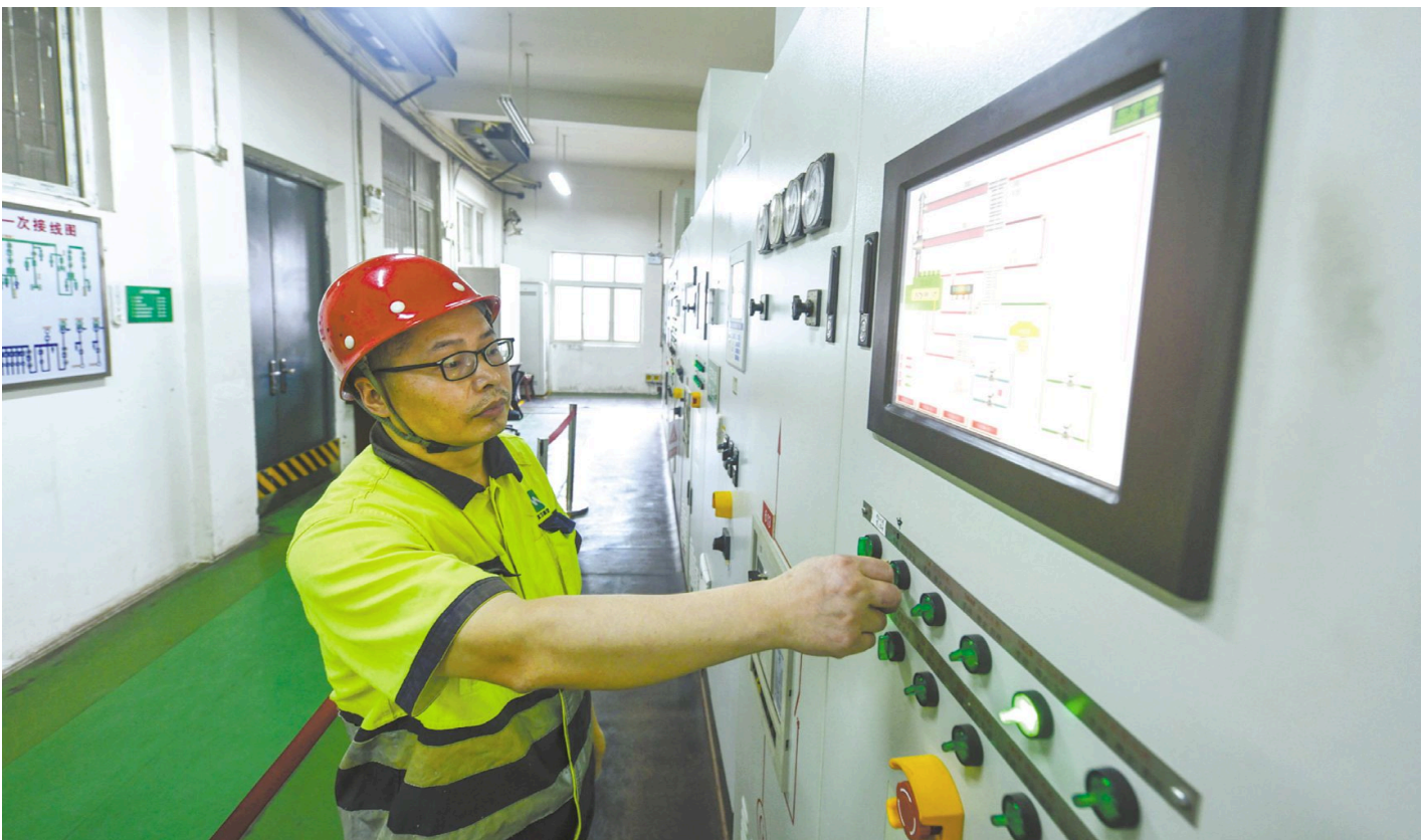
重庆市环卫集团黑石子餐厨垃圾处理厂垃圾发电车间控制室内，一名工作人员在检查仪表盘上的数据。
