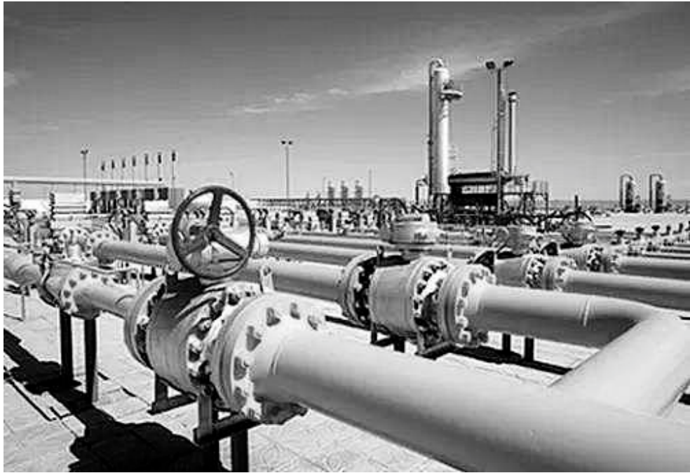
天然气传输管道
