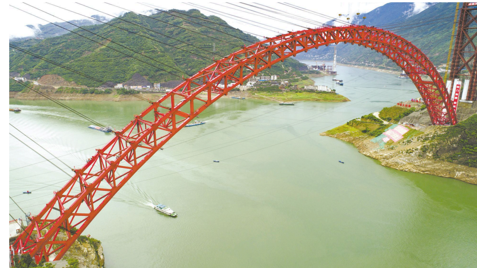
这是5月22日在湖北省秭归县拍摄的香溪长江大桥主拱合龙现场(无人机航拍)。当日，由中铁大桥局承建的世界最大跨度钢箱桁架推力式拱桥——香溪长江大桥主拱成功合龙。香溪长江大桥是三峡移民后续工作的重大项目之一，位于三峡库区湖北省秭归县内，桥梁全长883.2米，主跨531.2米，桥面宽32.3米，为一跨过江、双向四车道公路桥。新华社发(王罡摄)
