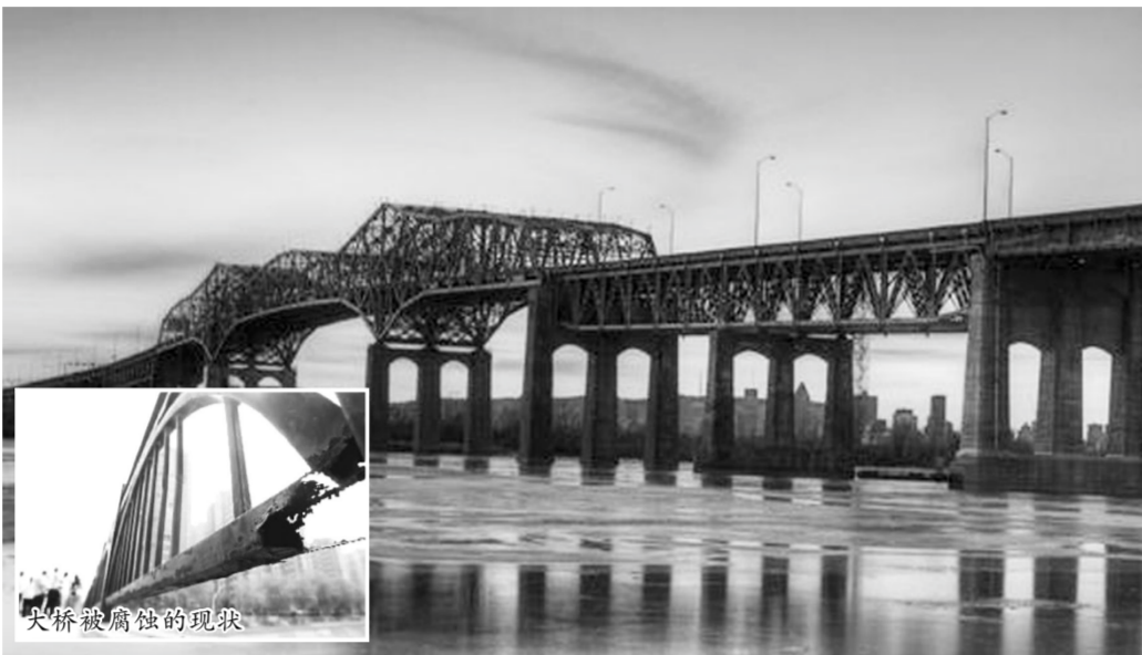
大桥被腐蚀的现状
