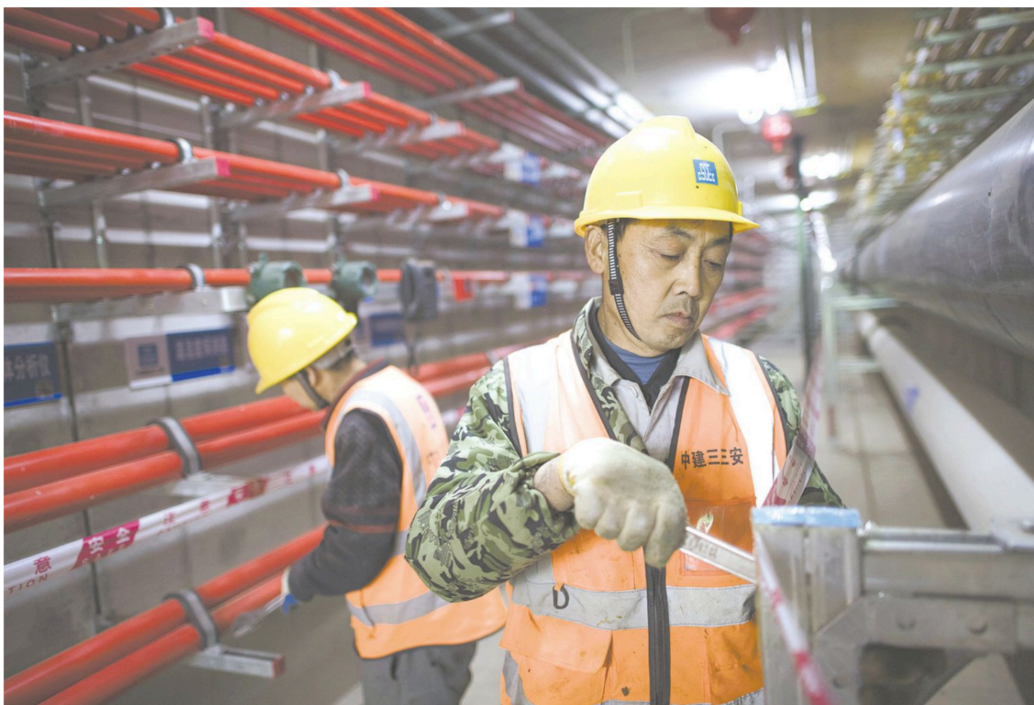
12月13日,施工人员在廊体内进行安装作业。近日,由中建三局三公司承建的湖北咸宁城市地下综合管廊PPP项目一期建设工程正处于主体结构施工及廊内安装阶段。该工程建成后可将原本一条条单独铺设的线缆管集中,使城市告别“蜘蛛网”“拉链路”,成为改善城市治理的“收纳神器”。据悉,该项目位于湖北省咸宁市高新技术产业园区,两条综合管廊共计5.06公里,初步规划入廊管内有电力、给水、燃气、通信、中水等5类管线,预计于2019年4月完工。新华社记者肖艺九摄
