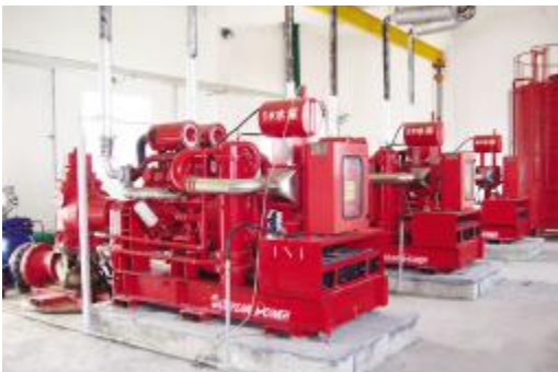
广州港鸿业石化码头应用三业智能柴油机消防水泵
