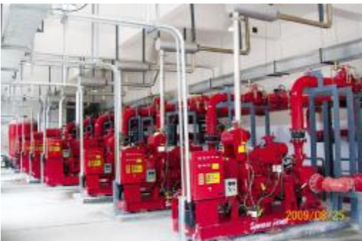
上海波音机库应用三业数字定压柴油机消防水泵
