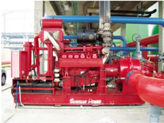
广东东莞九丰油库应用三业智能柴油机消防水泵
