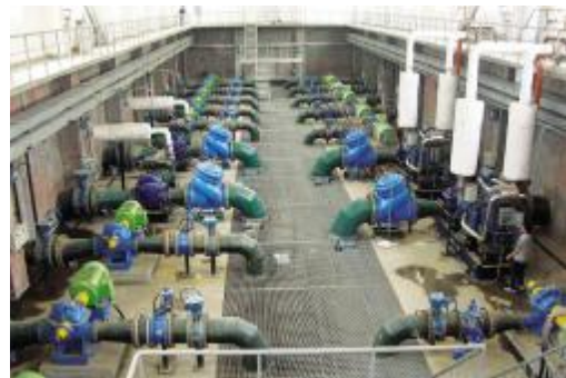
金川集团应用三业智能柴油机水泵作为冶炼高炉循环冷却水应急给水
