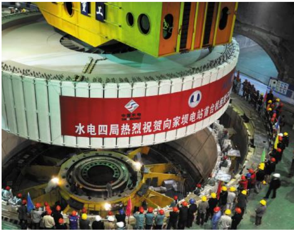
11月12日,世界单机容量最大的水轮发电机组——向家坝水电站1号机组转子顺利吊装就位。至此,1号机组正式进入总装阶段,为确保该机组2012年投产发电奠定了基础。
