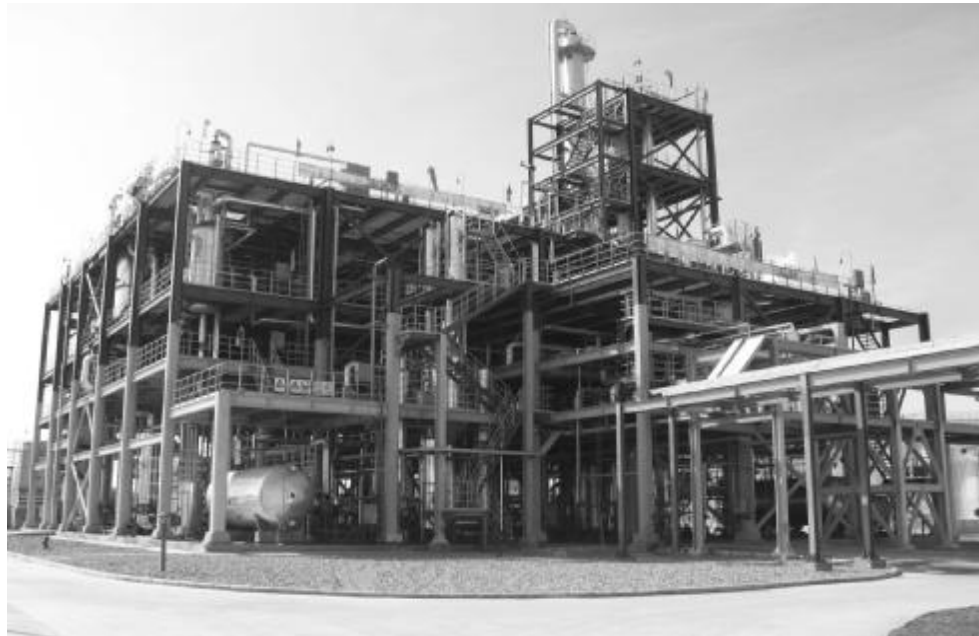
亚临界酯交换生物柴油生产工艺装置
